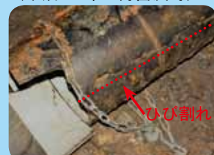
破損のため撤去した水道管 (昭和 29 年布設 φ 250 mm)
