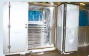
冷凍庫 余市工場700t、ホールミール工場1,400t
